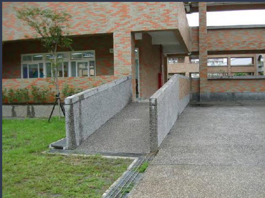
坡道地面不平整
